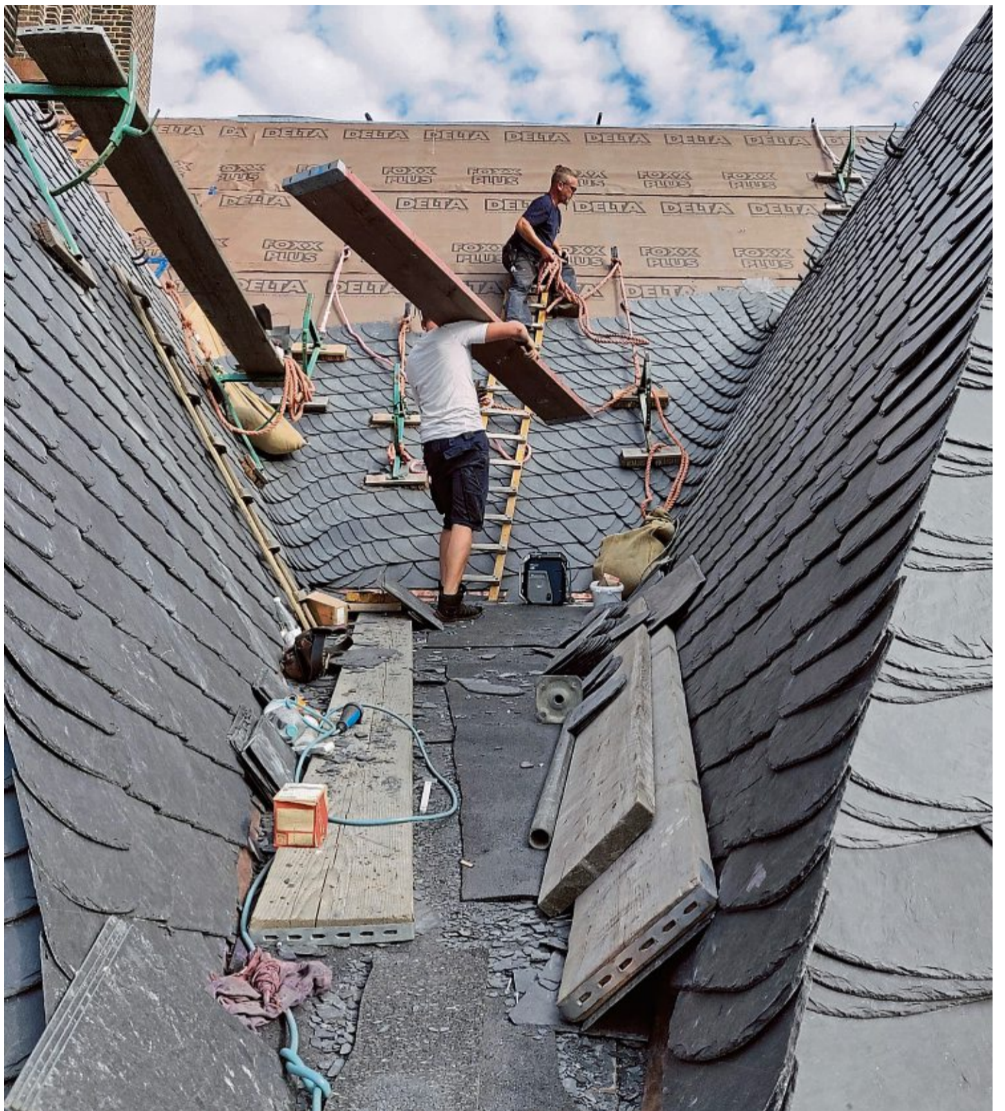
Vor allem auf der Südseite musste das Kirchendach in Handarbeit erneuert werden.
